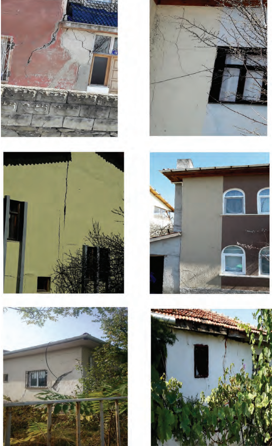
Şekil 1. Güdül yerleşim alanındaki binalarda izlenen çatlak oluşumları.
